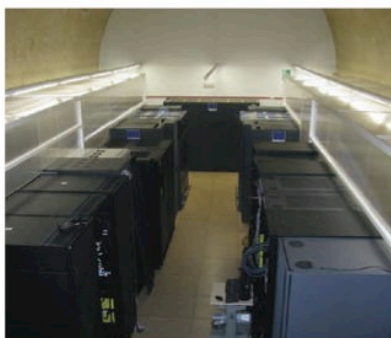
Centro de Proceso de Datos de CETA-CIEMAT. CETA-CIEMAT Data Processing Centre.
